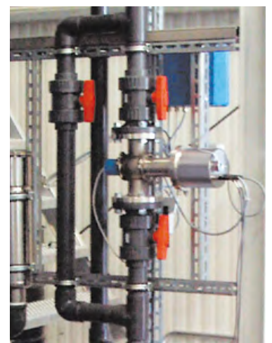
Einbau in geradem Rohr mit Ultraschall-Reinigungssystem
