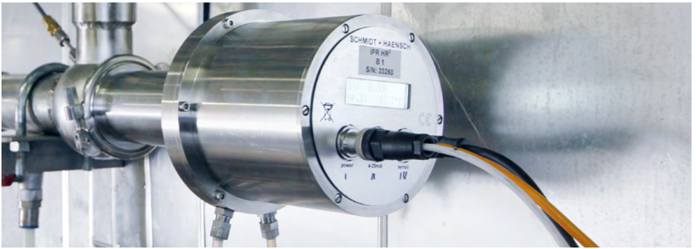
90° Rohrinstallation mit Flüssigkeitshochdruck-Reinigungssystem
